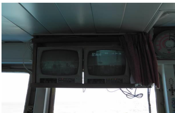
Οι οθόνες του μόνιμου συστήματος παρακολούθησης, τοποθετημένες στο πρωραίο μέρος της γέφυρας.
