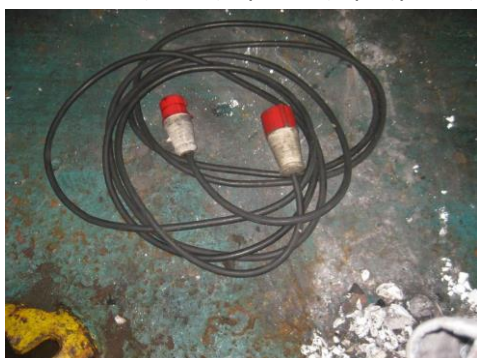
Προέκταση για τη σύνδεση των ψυγείων φορητών/οχημάτων με τους ρευματοδότες του πλοίου
