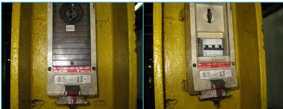
Ρευματοδότης για την τροφοδοσία των φορητών ψυγείων
