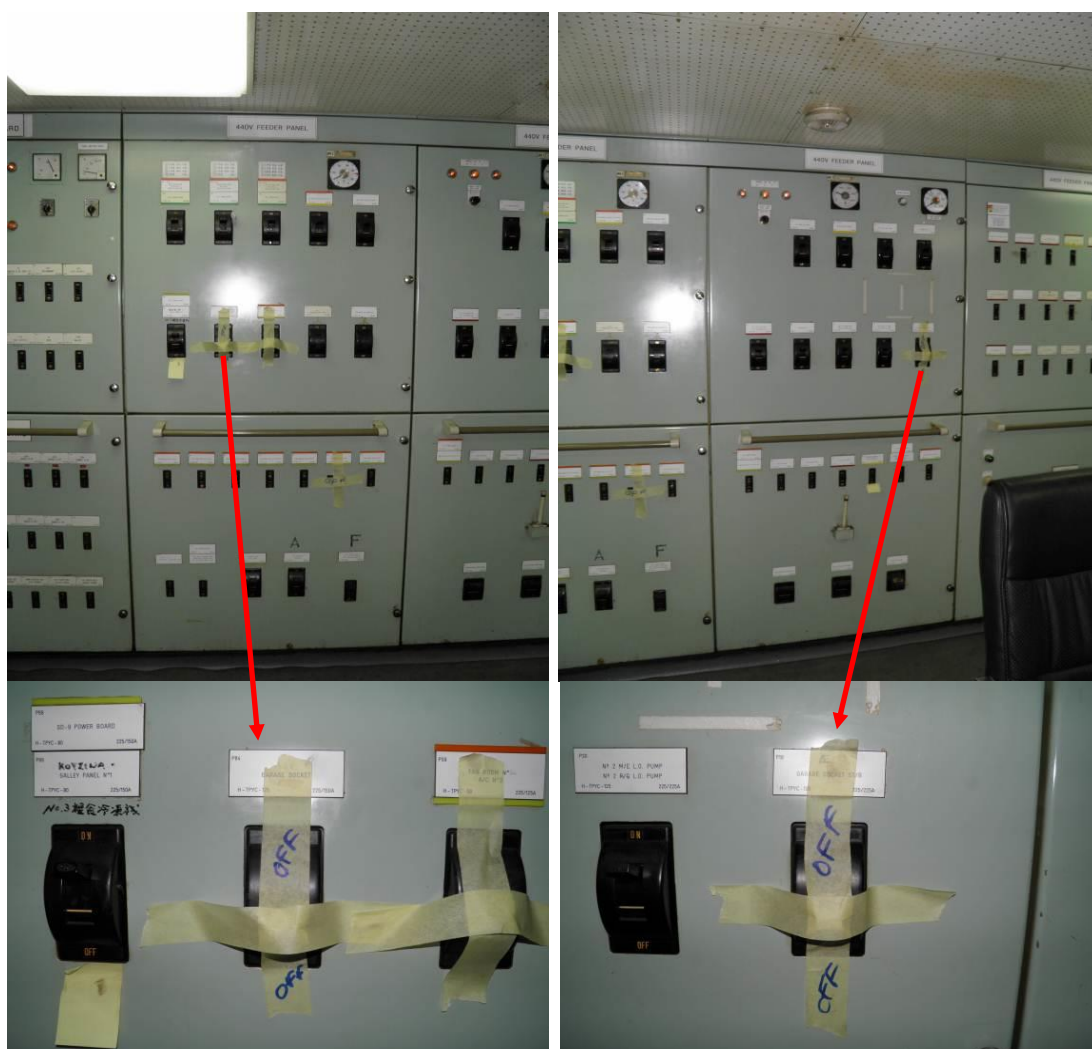
Κεντρικός πίνακας διανομής ηλεκτρικού ρεύματος στο Ε.С.R. όπου απεικονίζονται οι διακόπτες για τους ρευματολήπτες στο χώρο του γκαράζ.
